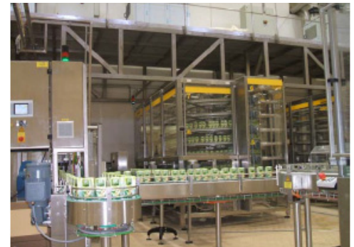
Die Fruchtsaftpackungen beim Verlassen der Füllstation.
